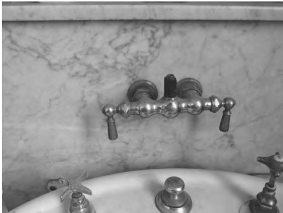
Llaves de agua de la peluquería del Club.
